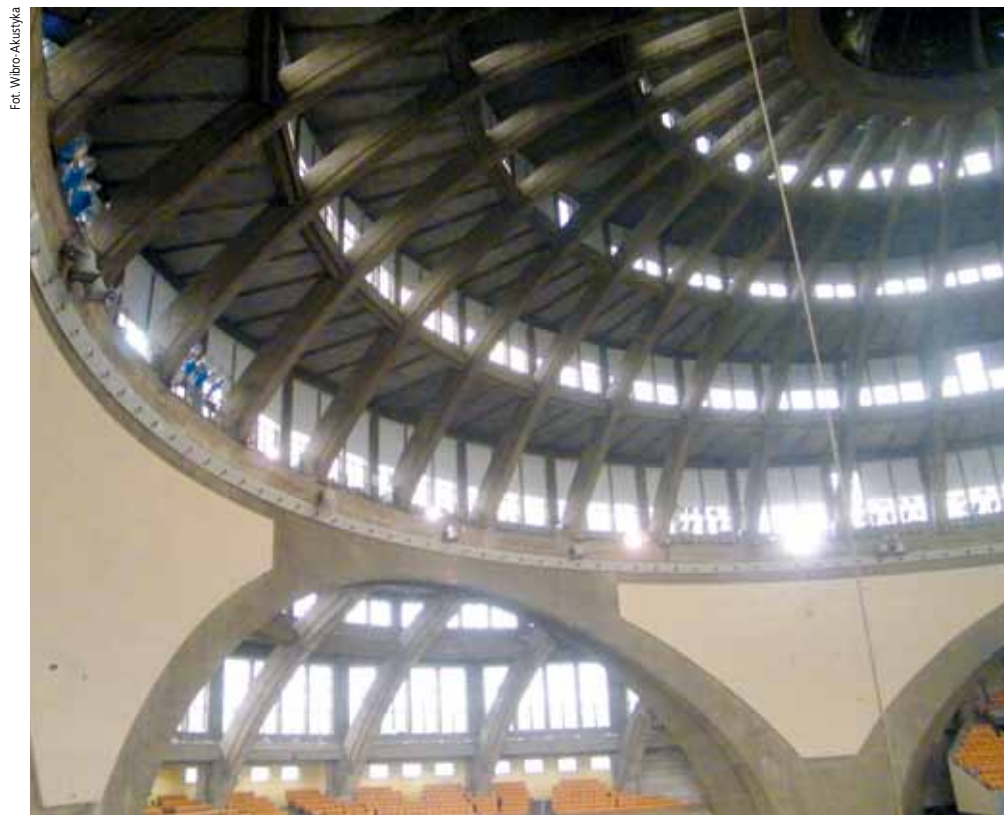
Rys. 1: Tynk dźwiękochłonny SonaSpray w Hali Stulecia we Wrocławiu
